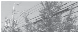
電線を保護するカバー
