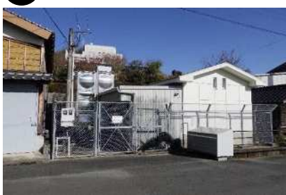
② 内田ポンプ場
