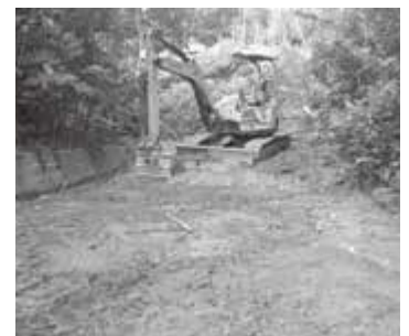
林道の損壊現場
