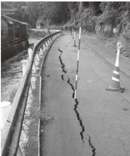
町道梯本線の亀裂
