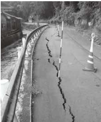
町道梯本線の亀裂
