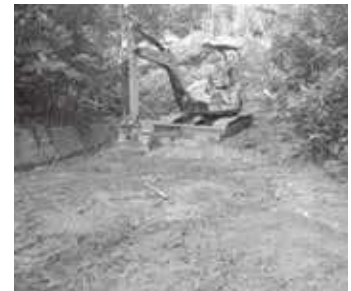
林道の損壊現場
