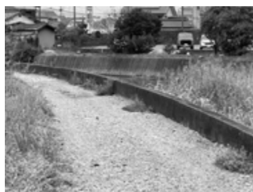
護岸の高さが違い手前側に越流する河川
