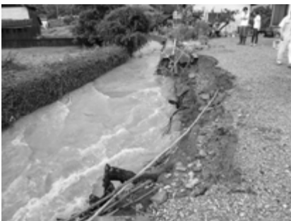
河川氾濫後の被害状況
