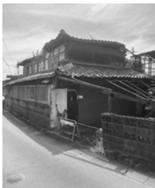
老朽化した空き家
