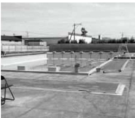
老朽化した中学校プール
