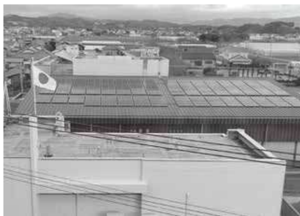
「いこつと」の屋根に設置された太陽光パネル
