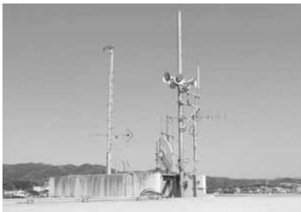
現庁舎の防災無線アンテナ等設備
