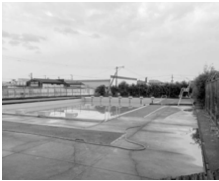
昭和 36 年に作られた老朽化した広川中のプール
