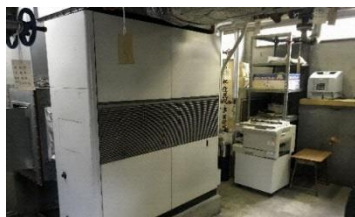
▲空調設備の劣化状況
