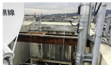
▲受水槽の劣化状況
