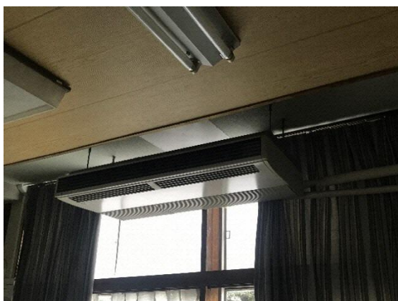
▲空調設備の老朽化
