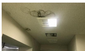
▲天井の漏水跡
