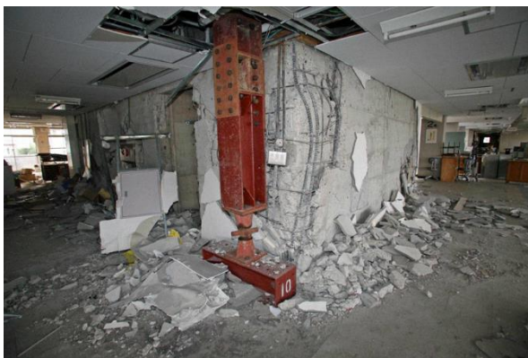
▲東日本大震災後の福島県須賀川市役所 （写真：須賀川市HP 須賀川市内における被災状況から）
