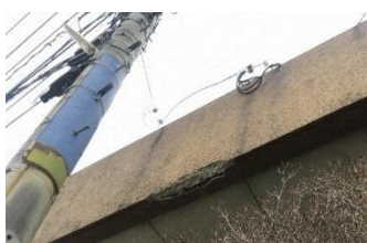
▲外壁の劣化状況
