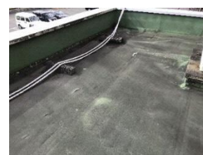
▲屋根の劣化状況
