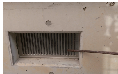
▲棒の高さまで水位が上昇(床下換気口)
